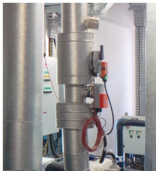
Abb. 82: Die Versorgung der Gebläsekonvektoren ist mit dem Belimo Energy Valve™ ausgestattet.
