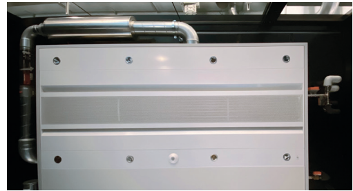
Abb. 83: Deckenintegrierter Kühlbalken mit Luft- und Kaltwasserversorgung.
