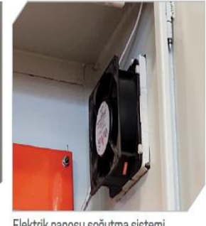
Elektrik panosu soğutma sistemi
