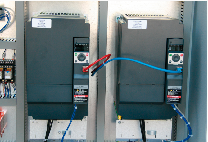
Inverter zur Einstellung der Luftleistung. Inverter unit to adjust capacity.
