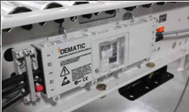
Die integrierte Fördertechnik-Steuerung (ECC) steuert eine Vielzahl von Rollenmotoren
