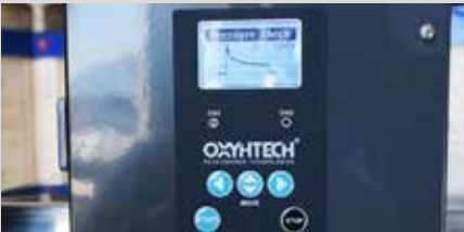
Prüfen der Bedingung des Filters / Druckregelung Differenz
