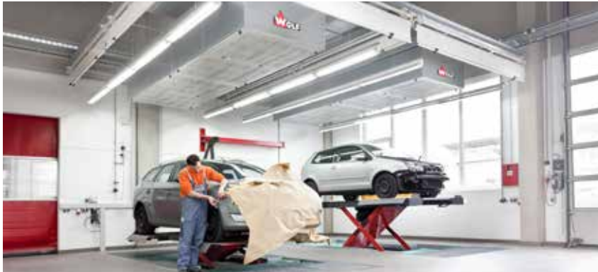
Spot-Repair Bereich: Floor System mit Filterdecke, Beleuchtung, Trennrollos
