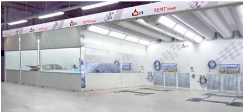
Spot Repair-Anlage: Wall System mit Beleuchtungsbalken, Trennrollos, je Platz 3 textile Zuluftkanäle
