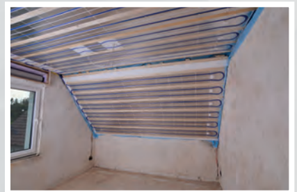
Deckenkühlung im Dachausbau eines Einfamilienhauses
