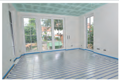
Fußbodenheizung im Anbau eines Einfamilienhauses
