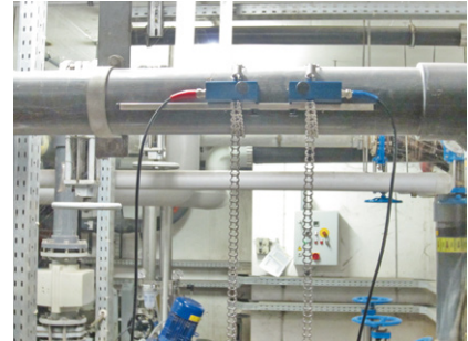
Thermal energy metering at Stadtwerke München
