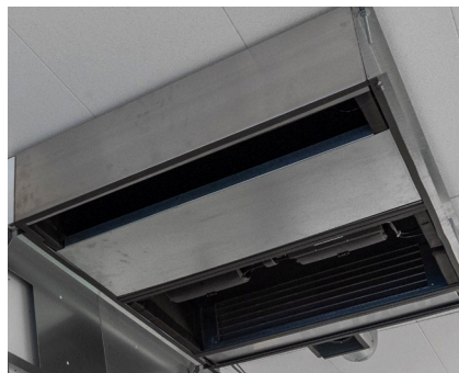
Abbildung 5: Revisionsöffnung für Ventilator und Wärmeübertrager.
