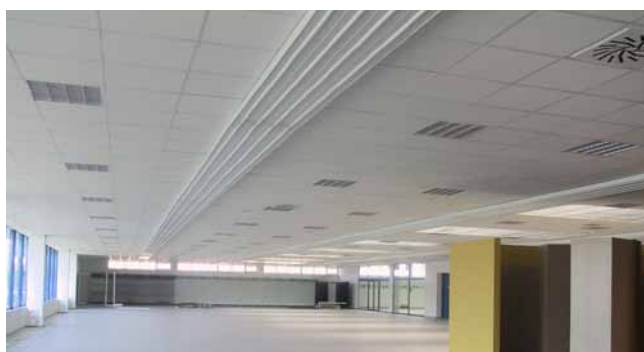
Integration einer KSP Akustik 600 in eine Rasterdecke
