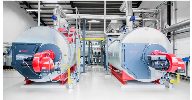
Die zwei effizienten Bosch-Dampfkessel liefern insgesamt bis zu 8 t/h Dampf.
