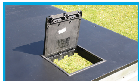
Geräteinsatz im Podest
